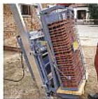
A kétsébséges szállításhoz emelő a le a tetőre gyorsan megkaphat a csigával szállított anyag megfogását a tető felületén.
